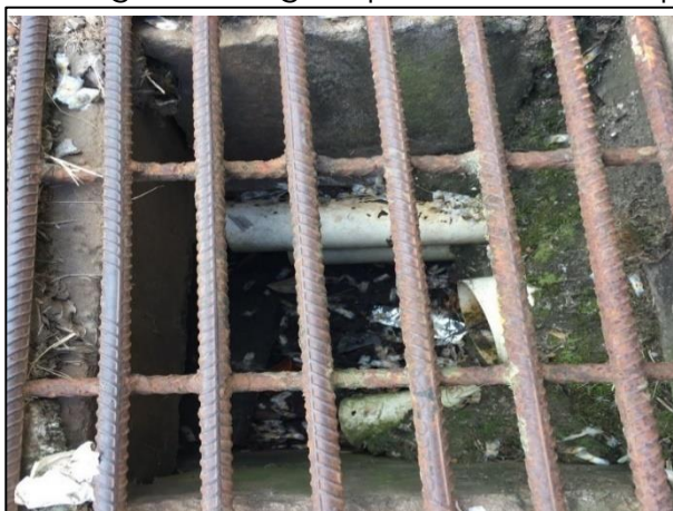
Figura 8 - Sistema de drenagem das águas pluviais do município de Protásio Alves
