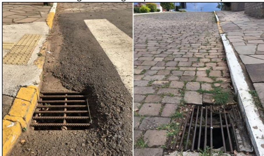
Figura 7 - Sistema de drenagem das águas pluviais do município de Protásio Alves
